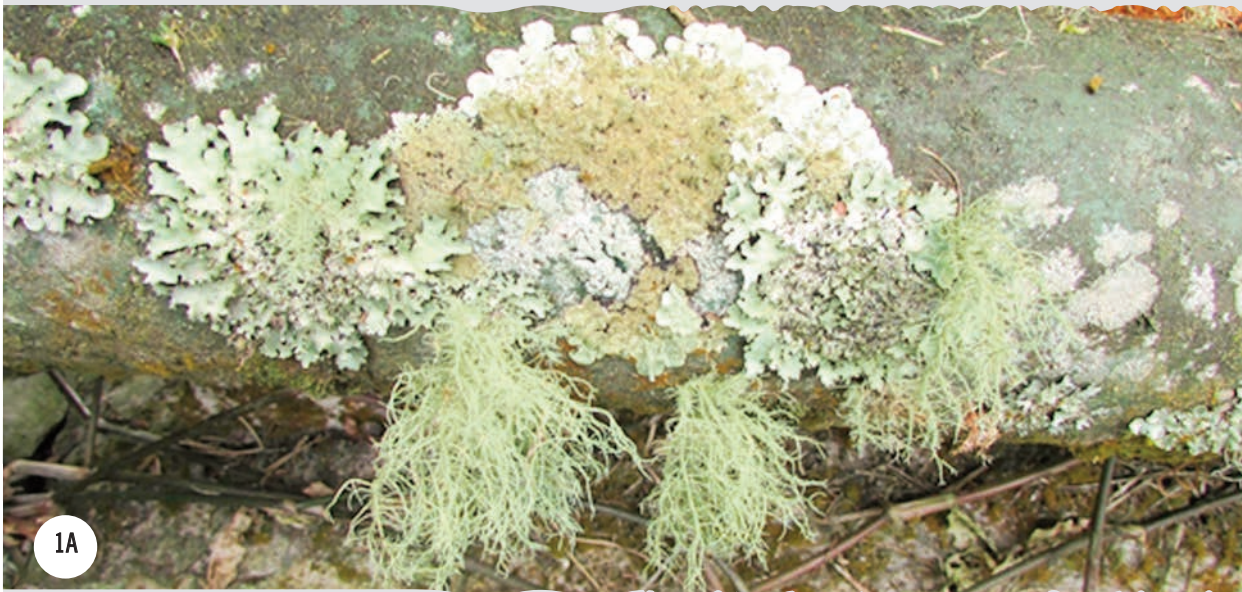
Macrolíquenes creciendo sobre un tubo de agua de asbesto. Fotografías: R.E. Pérez-Pérez
